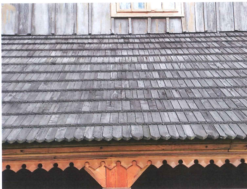
14. ZESCHNIĘTY I WYJĄLOWIONY GONT I DESKI OŁACENIA – STRONA POŁUDNIOWA.
