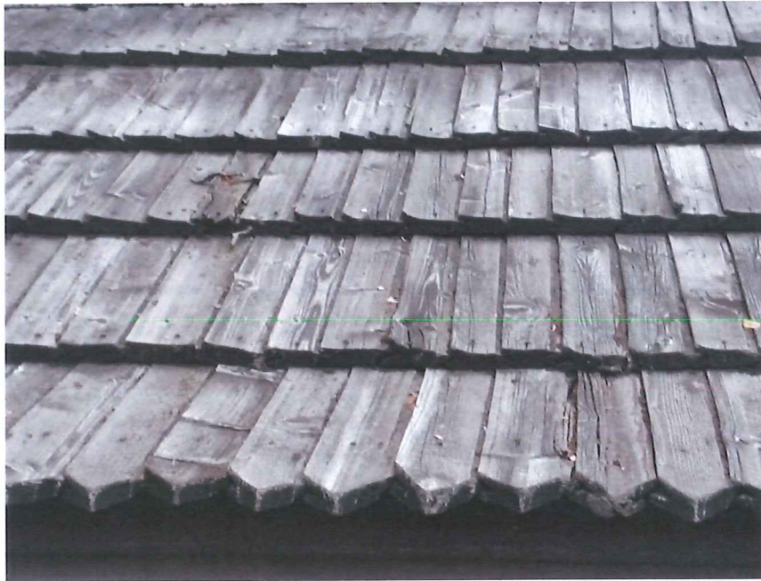
15. ZESCHNIĘTY ZDEFORMOWANY I NIESZCZELNY GONT NA POŁACI POŁUDNIOWEJ.
