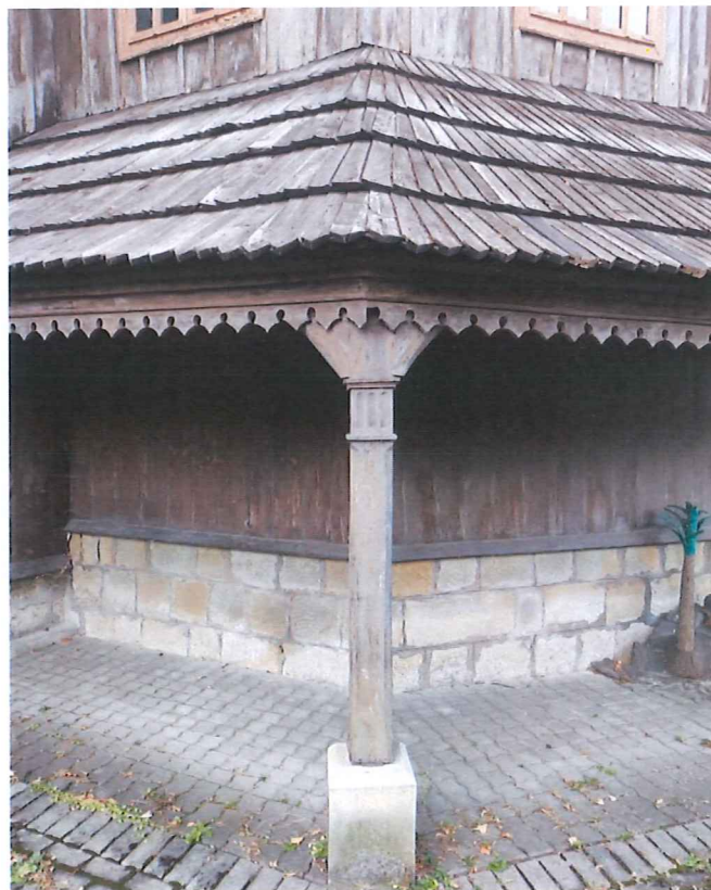
16. NAROŻNIK POŁUDNIOWO WSCHODNI SOBOTY. WYJĄLOWIONY GONT, DESKI OŁACENIA I OKNA.
