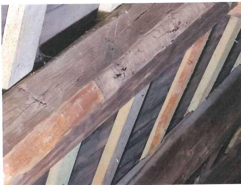
22. ŚLADY REMONTU NIEFACHOWEGO. FLEKI KROKWI I NIEIMPREGNOWANE ŁĄTY POD GONT.
